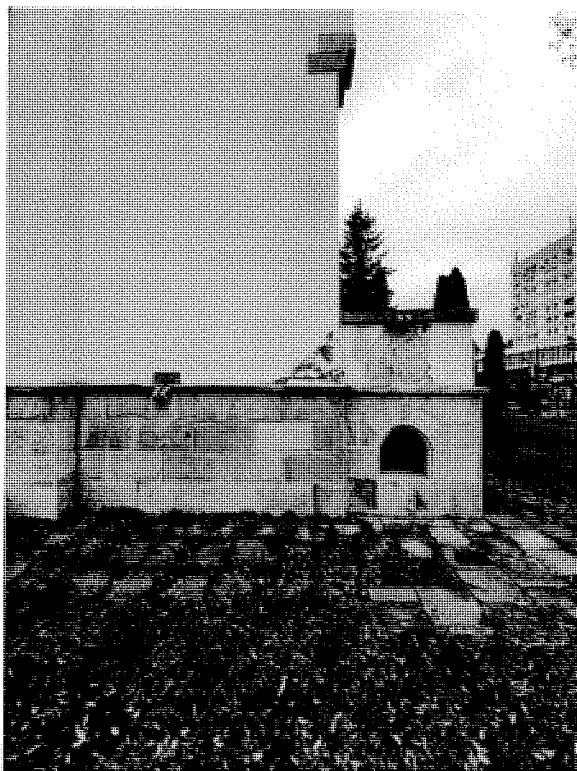
Foto 40 – Tasări diferențiale scară acces pridvor – fisurare soclu
