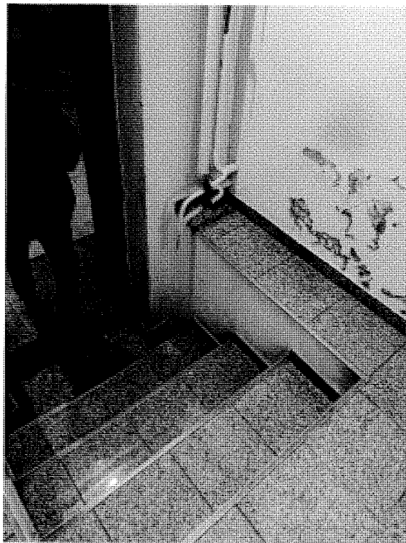
Foto 06 – Infiltrații la nivelul pereților
