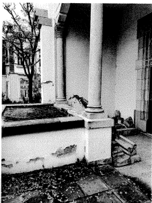
Foto 42 – Exfolieri tencuială scară exterioară pridvor–fisurare soclu și depozitare ornamente scoase în urma unei intervenții anterioare
