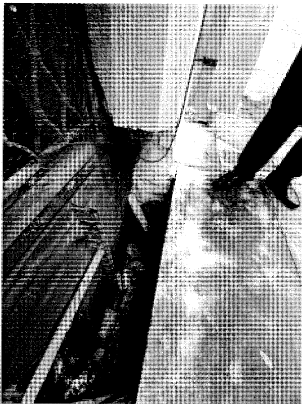
Foto 36 – Distrugere ornamente piatră și zidărie, nereparate în jurul golului de fereastră subsol
