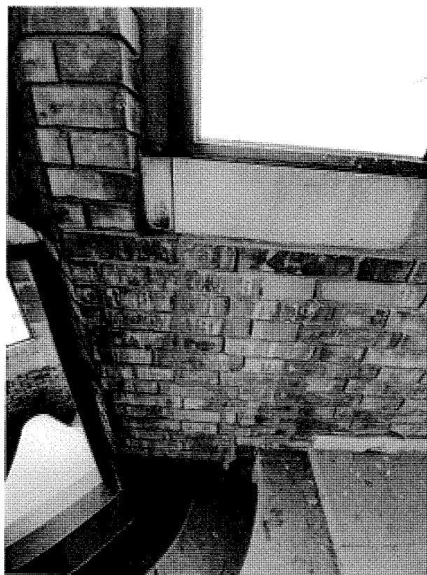
Foto 27 – Fisură parapet fereastră turn
