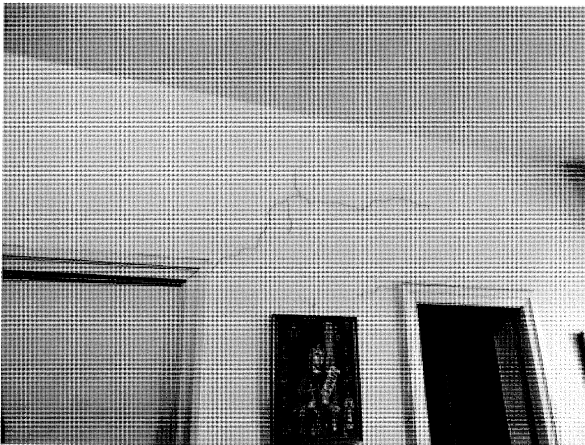
Foto 47 – Fisuri înclinate apărute deasupra golurilor de uși de acces în bibliotecă
