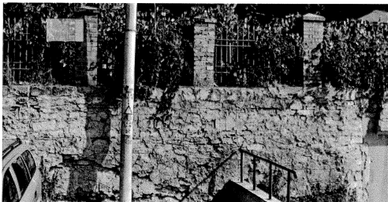
Foto 59 – Dislocare zid prin împingere pământ sub efectul apelor pluviale
