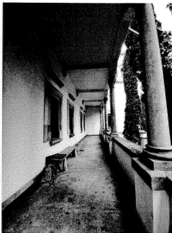
Foto 41 – Pardoseala cerdac nefinalizată de la ultima încercare de intervenție cu posibilitatea pătrunderii apelor meteorice spre planșeu subsol
