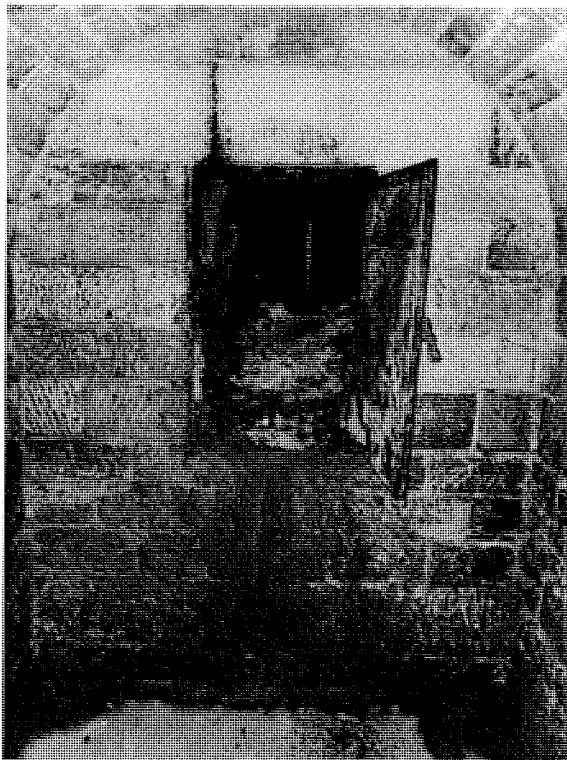
Foto 10 – Blocare continuitate ziduri beci și umezirea zonei
