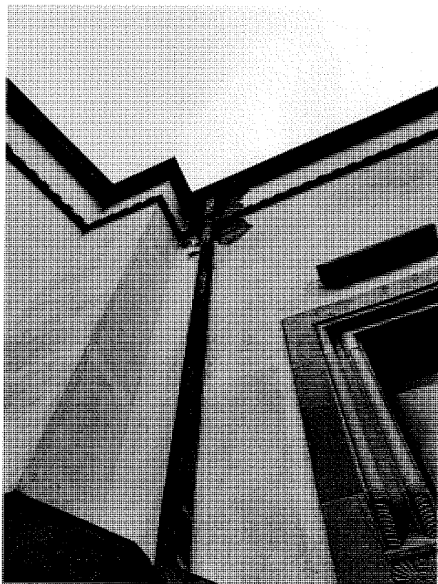
Foto 38 – Jgheaburi și burlane neetanșe Dizlocări de tencuială
