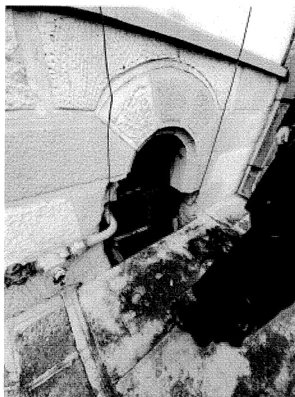
Foto 35 – Distrugere ornamente piatră și zidărie, nereparate în jurul golului de fereastră subsol
