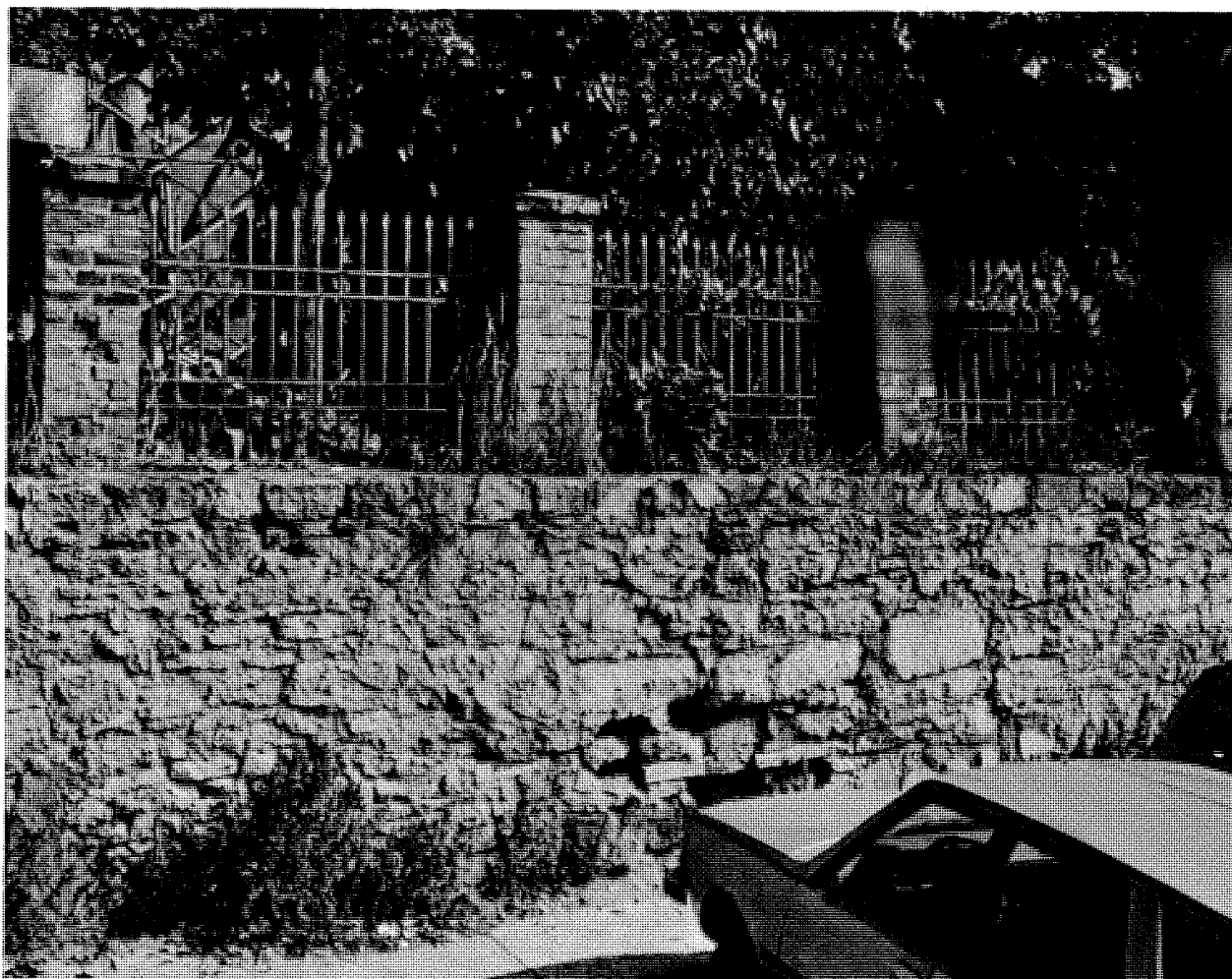
Foto 58 – Blocuri de piatră dislocate și măcinate de intemperii și gelivitate Fisuri înclinate cauzate de tasările inegale
