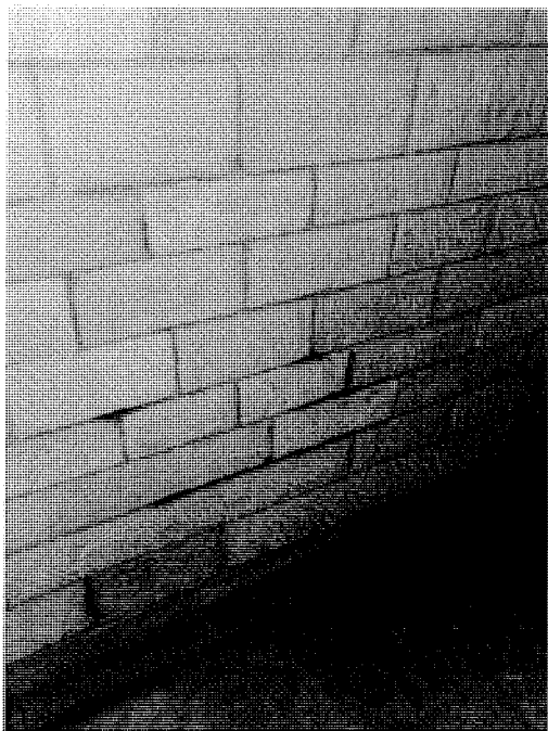
Foto 12 – Refacerea rosturilor după expulzarea mortarului de legătură cauzată de umiditate
