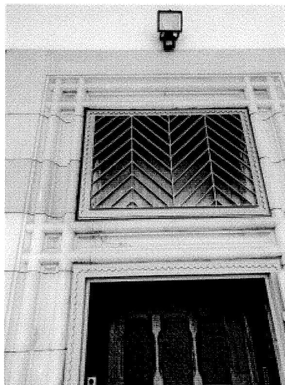
Foto 33 – Fisuri în ornamentele de piatră la ușile de acces și supralumină
