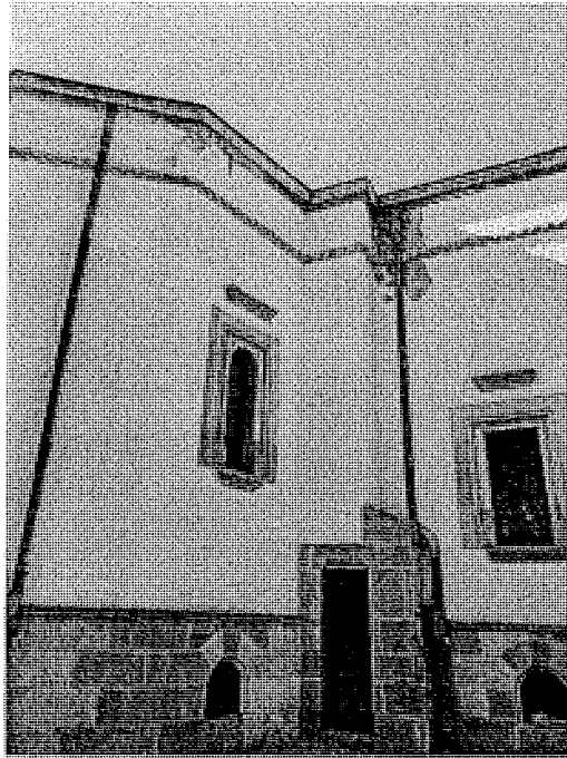
Crapaturi, fisuri si desprinderi de tencuiala la peretii Salii Gotice
