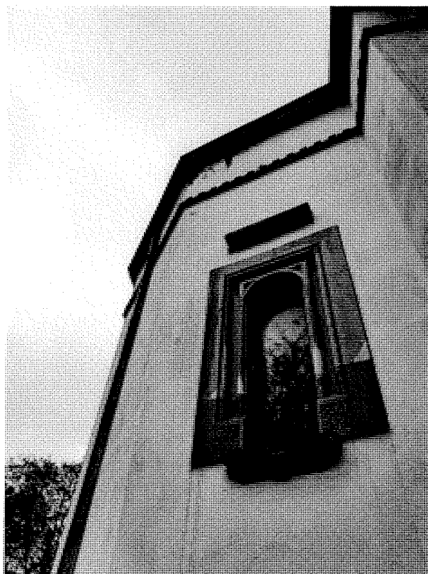
Foto 39 – Infiltrații ape pluviale prin jgheaburi neetanșe și dizlocări de tencuială
